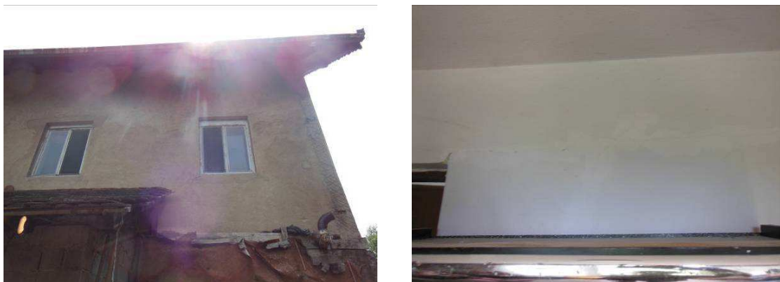
Slika 3.8.2. Registrovane deformacije na porodičnoj kući Novice Dimitrijevića: (a) pukotine iz prozorskih okana prema dvorištu, (b) pukotine u hodniku kuće, sanirane (foto S. Kostić)
