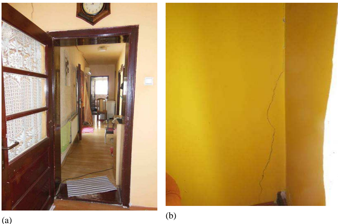
Slika 3.5.3. Registrovane deformacije na porodičnoj kući Saše Arsića: (a) nakrivljeni profil vrata; (b) pukotina u dečjoj sobi ( foto S. Kostić )
