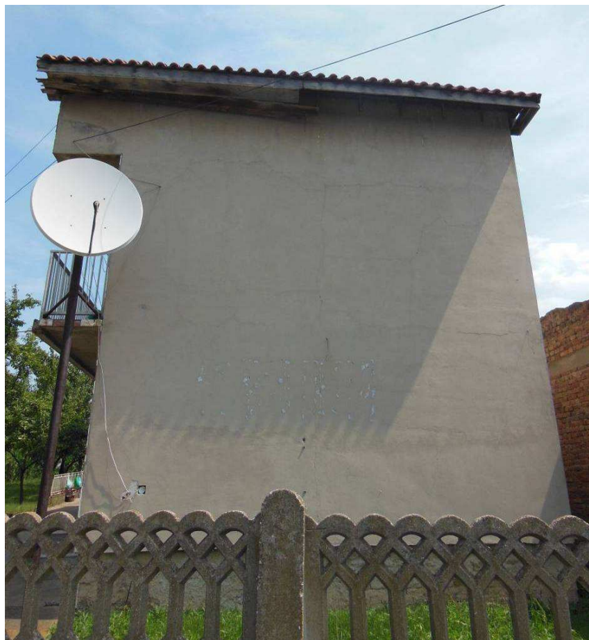
Slika 3.6.2. Registrovane deformacije – kose pukotine na porodičnoj kući Ranislava Brkića (foto S. Kostić)
